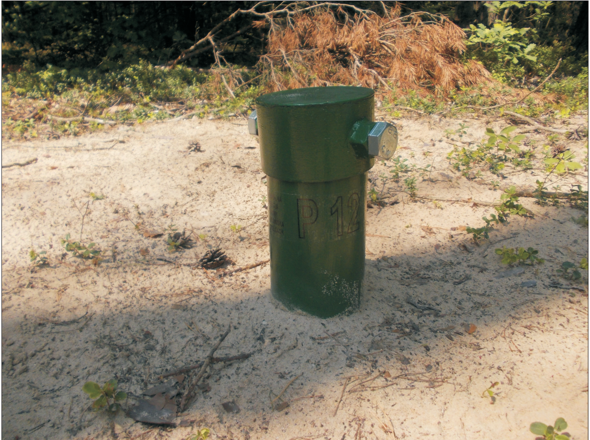
Fot. 11. Piezometr P 11 - wykonany na dziale wodnym w sąsiedztwie nowej drogi leśnej , (R. Spiżewski).
