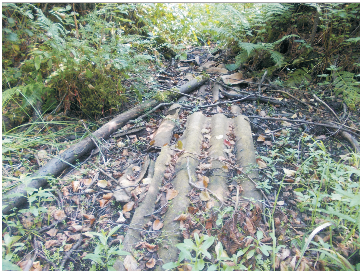
Fot. 04. Suche koryto "rowu zachodniego" wypełnione płytami eternitowymi, (R. Spizewski).
