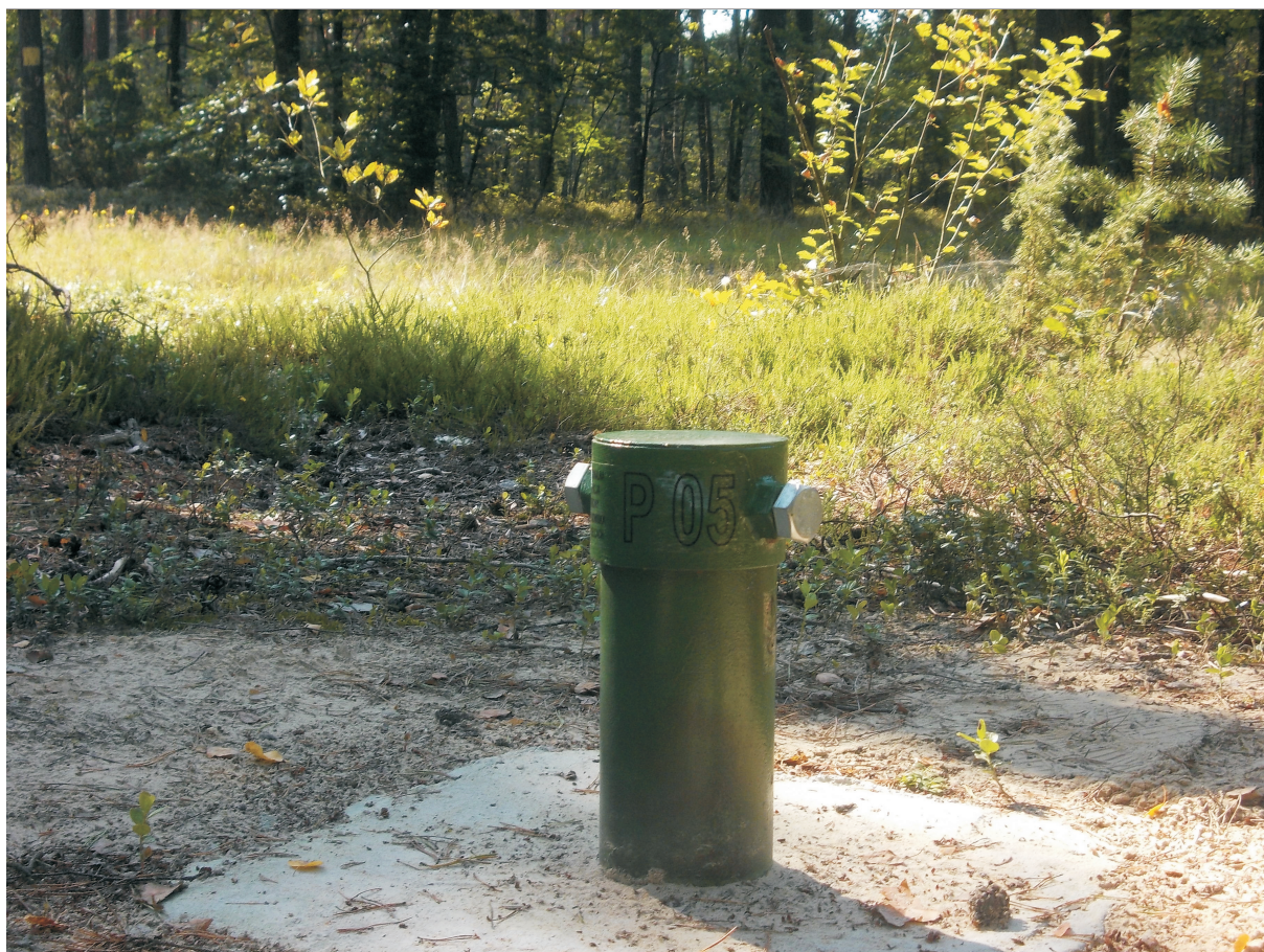
Fot. 08. Piezometr P 05 wykonany na granicy boru świeżego, przy drodze leśnej, (R. Spiżewski).
